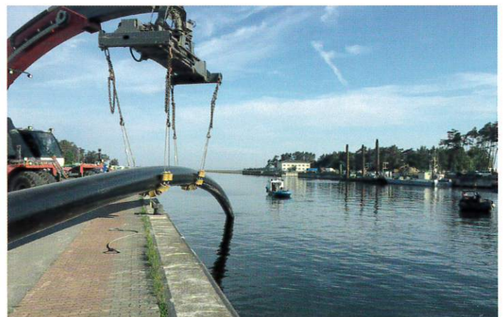
Abb. 12: ... und anschließend im Lubminer Hafen zu Wasser gelassen. | Foto: Beermann Bohrtechnik GmbH
