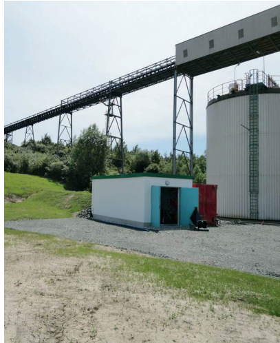
Abb. 7 – Bau der Fassungsbauwerke am Start- und Zielpunkt der Bohrung sowie der Bauwerke für die Grundwasserreinigung
