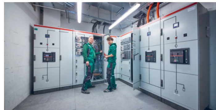
Herzstück: Niederspannungsverteilung der Sicherheitsstromversorgung
